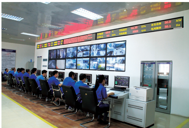
塔国杜尚别2号火电厂主控室运行调试-特变科技合作中心。
